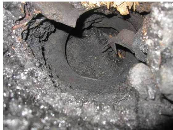
Abb. 8-16 Verschlackung im Reformer nach GR3
