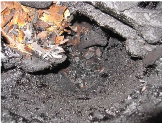
Abb. 8-15 Detailinnenansicht Reformer nach GR3
