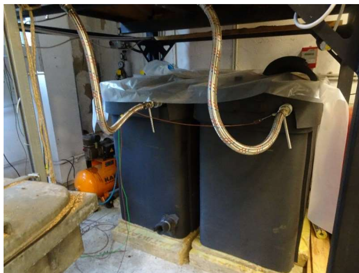
Abb. 2-53 Aufstellort der PCM-Speicher unter dem Vorratsbehälter der Anlage
