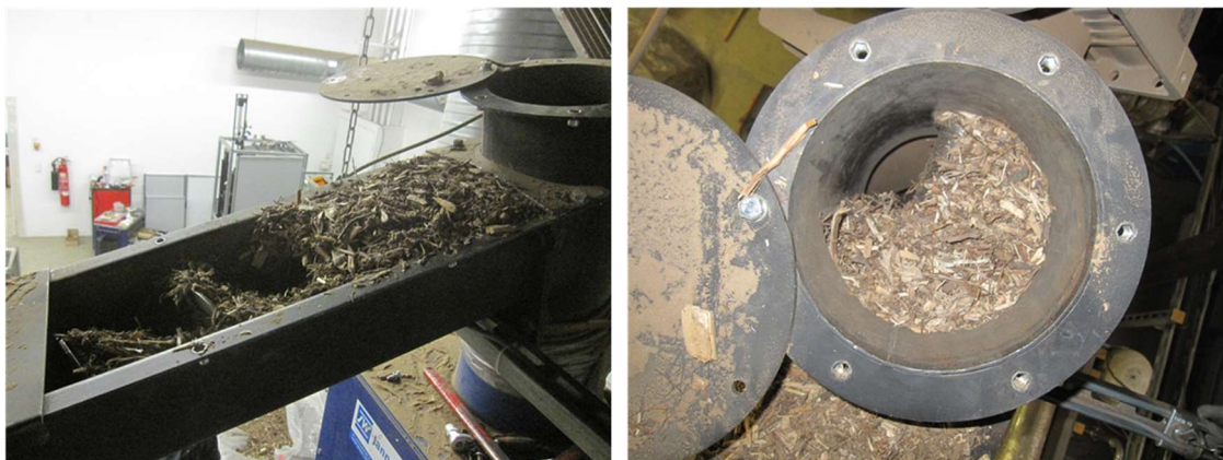
Abb. 2-28 Links: Verblockung des LPM zwischen Zuführschnecke und Schleuse im Bereich eines 90°-Bogens, rechts: Blick von oben in Schleusenfallschacht
