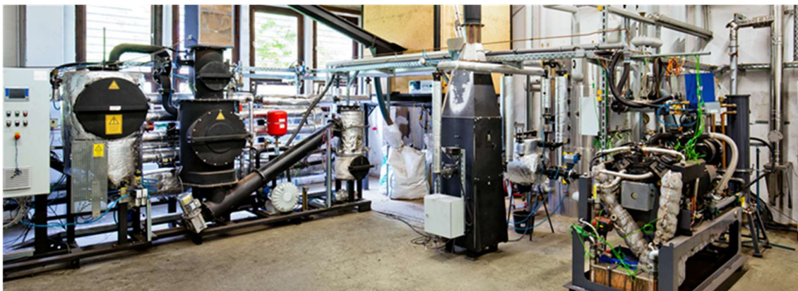
Abb. 2-1 Biomassevergasungsanlage im Thermochemischen Versuchsfeld (TCV) der HSZG
