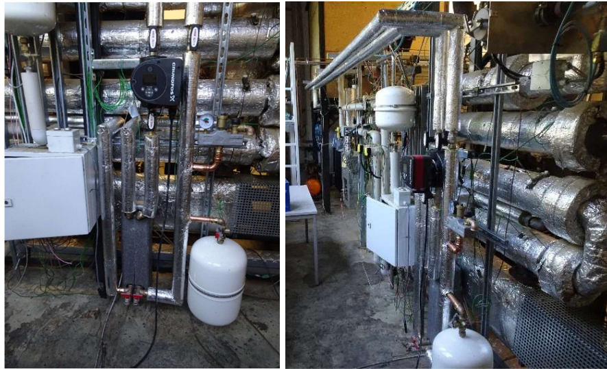
Abb. 2-55 Linkes Bild: Anschlussstelle des Speicherkreislaufes mit Umwälzpumpe, Membranausgleichsgefäß und Wärmeübertrager; rechtes Bild: gesamter Kreislauf mit Rohrstrücke zu den Speichern unter dem Brennstoffbehälter
