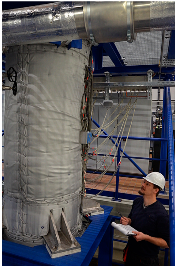
Abbildung 45: Herr Braun bei der äußerlichen Kontrolle des Gleichdruckverdrängungsspeichers an der VA THERESA
