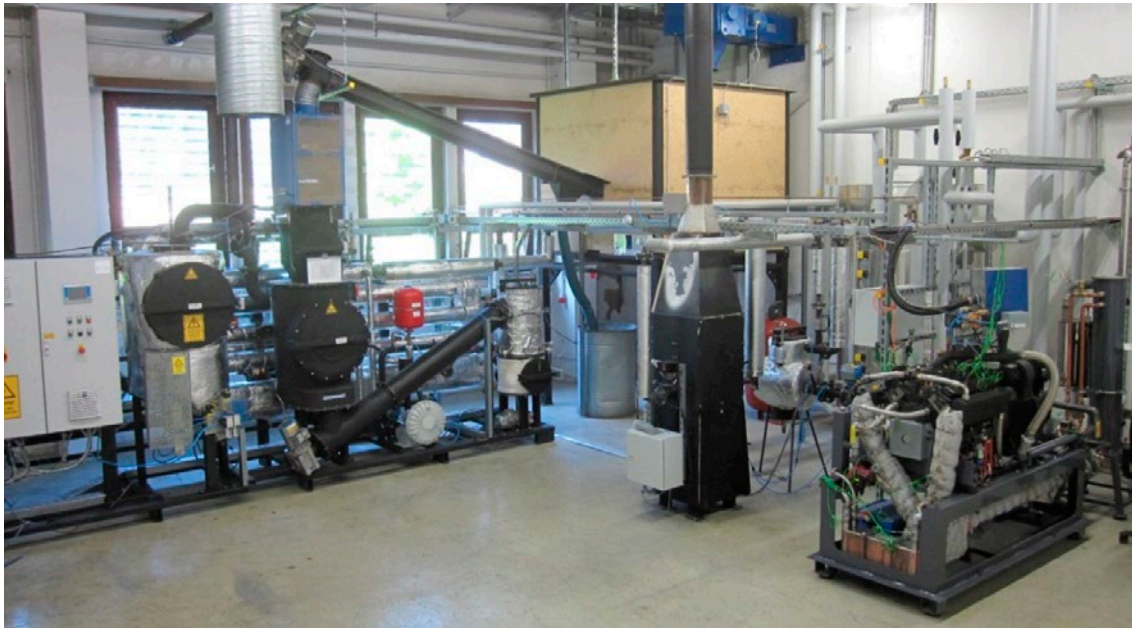
Abbildung 22: Übersicht des Holzgas-Blockheizkraftwerks
