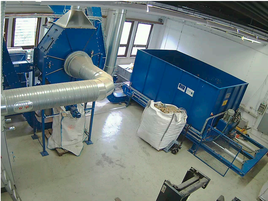
Abbildung 23: Trocknungsanlage für Holzhackschnitzel
