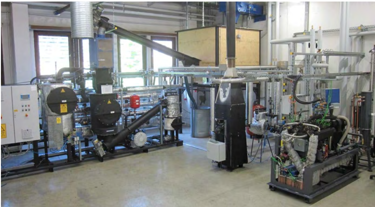
Abbildung 24: Übersicht des Holzgas-Blockheizkraftwerks
