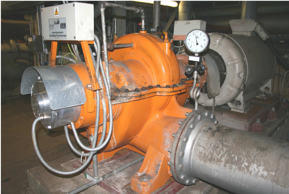
Abbildung 1: Einsatz der magnetgelagerten Pumpe als Betriebspumpe im Kraftwerk Boxberg
