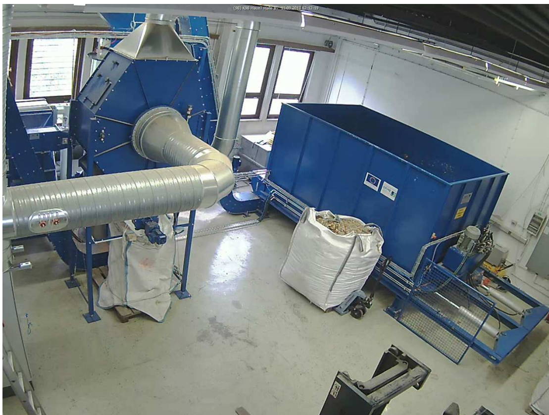
Abbildung 30: Trocknungsanlage für Holzhackschnitzel
