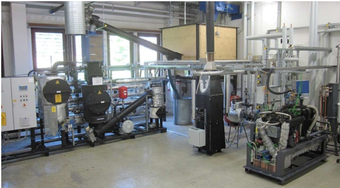
Abbildung 29: Übersicht des Holzgas-Blockheizkraftwerks
